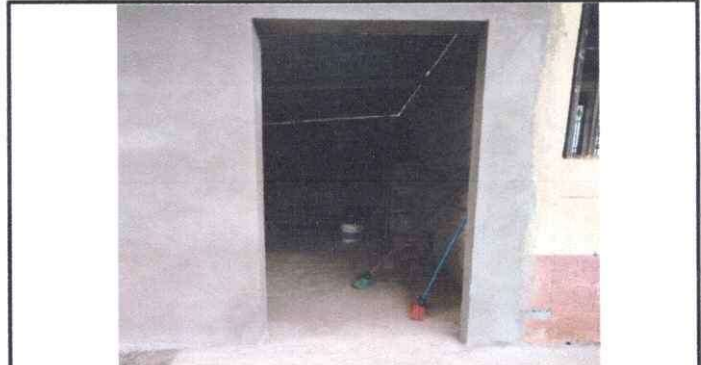
Foto 4: Dirección. Vista de la puerta a ser reparada.
