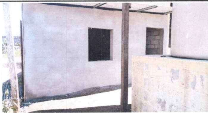
Foto 3: Dirección. Parte frontal. Se necesita puerta y ventana de balcon.
